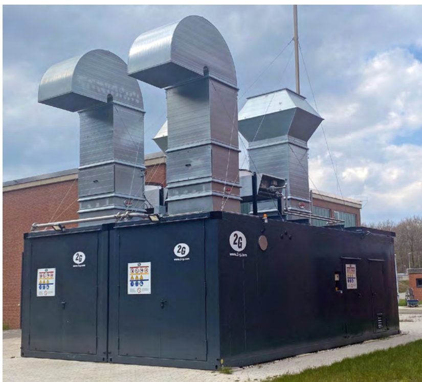
Herzstück der Energieautarkie: die Blockheizkraftwerke auf dem Gelände der Kläranlage
